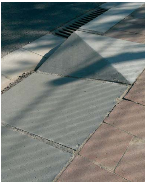
Foto Inferior. Detalle. Granollers. VADO DE VEHÍCULOS V57vg Bottom Photo. Detail. Granollers. V57vg DROPPED KERB
